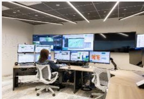
PiC① 監視センター概況
